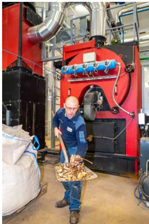
La chaufferie bois de Brezillet
